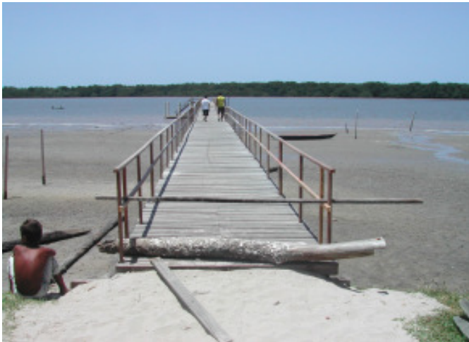
Interdição - Trapiche está fora de funcionamento há meses
